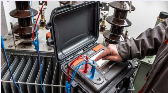
Messung mit dem MMR-650-Messgerät
