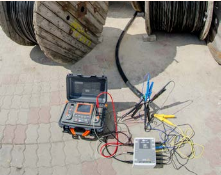
Mehradrige Messungen durch ein nur einmaliges Anschließen
